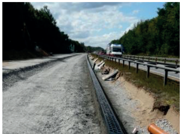
HYDROblock, Project: Autobaan A24, Hamburg - Berlijn
